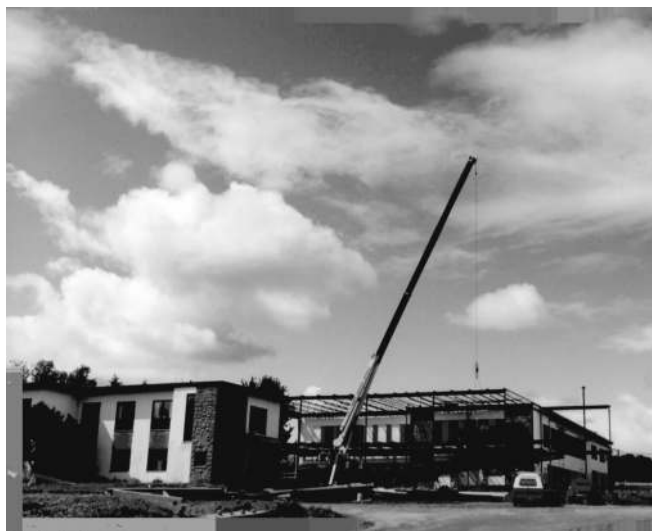
Rénovations de l'école Bellevue pour accueillir le centre collégial de Mont-Laurier qui manque cruellement d'espace au Pavillon. Source : Centre collégial de Mont-Laurier
